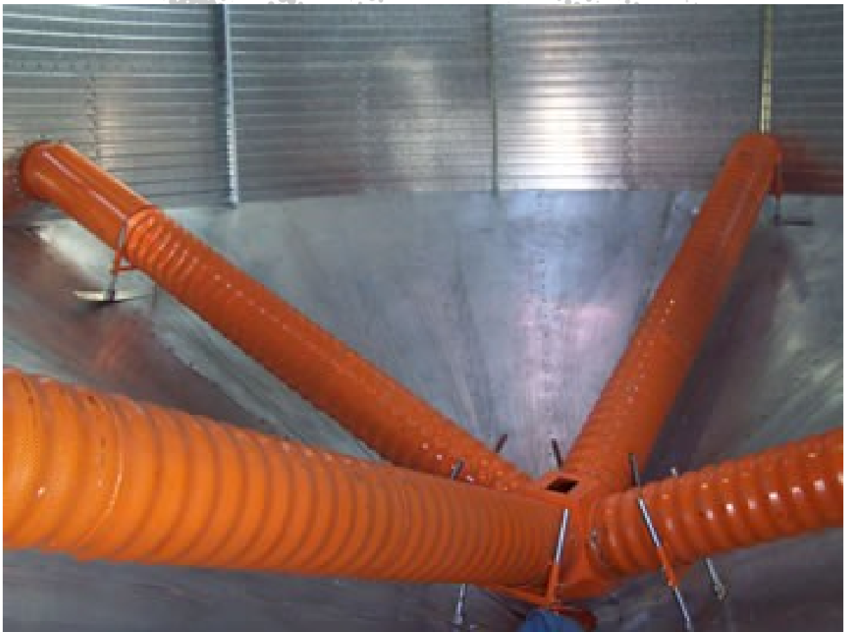
Sistema de distribución de aire
